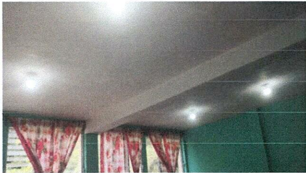
Foto 1: Mantenimiento de instalación eléctrica Posterior
